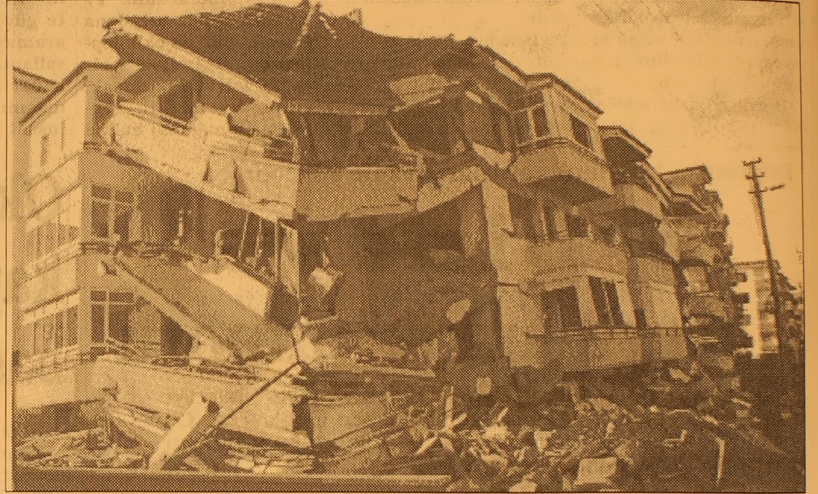
Yer Hacı Mehmet Mahallesi. Yolun sağında 5 katlı bir bina. Depremden sonra bina fotoğrafta görüldüğü gibi üç kata inmiş. Zemin bozuk olan arazilerde yapılan inşaatların birinci ve ikinci katında yaşayanlar, bugün hayatta değiller. Suçlu kim? Milyaryarlar para ödeyerek bu dairede oturanlar mı, yoksa altı çürük araziye imara açan ve kontrollerini yapmayan belediye mi? Yapılan inşaatın kontrol sorumlusu mühendis mi, demirden, çimentodan çalan müteahhit mi? Fotoğrafta görüldüğü gibi altta kalanların canı çıkmış. Kime ne! (Fotoğraf : Gemlik KÖRFEZ)
